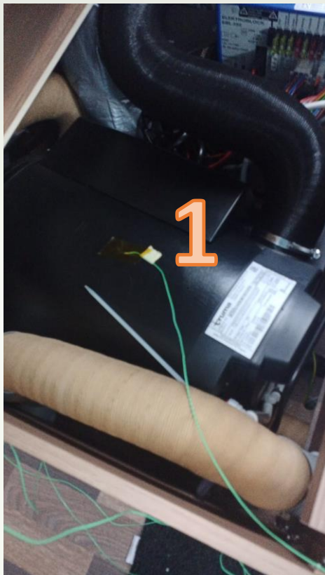
Fühler 1 Auf der Heizung
